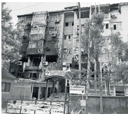
Terör örgütü Mardin, Şırnak ve Diyarbakır'da bulunan bazı DEDAŞ binalarına saldırılar düzenledi. Terör örgütünün yakıp yıkmaya faaliyetlerinden trafolar da büyük zarar görüyor.
