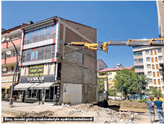
Bina, önceki gün iş makineleriyle ayakta desteklendi
